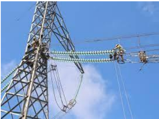
Đường dây tải điện
