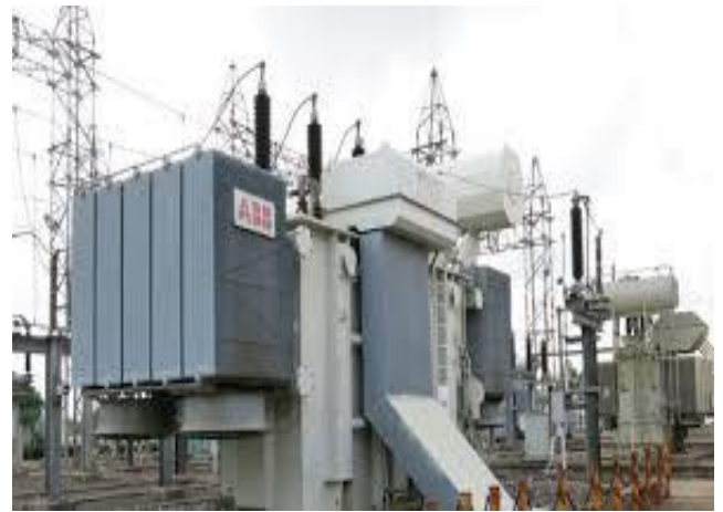
Trạm biến áp
